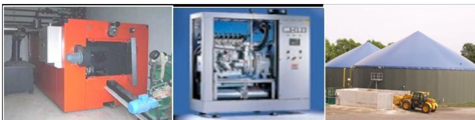
Bild 7. Kombikraftwerk: Hackschnitzelheizung, Blockheizkraftwerk und Biogasanlage
