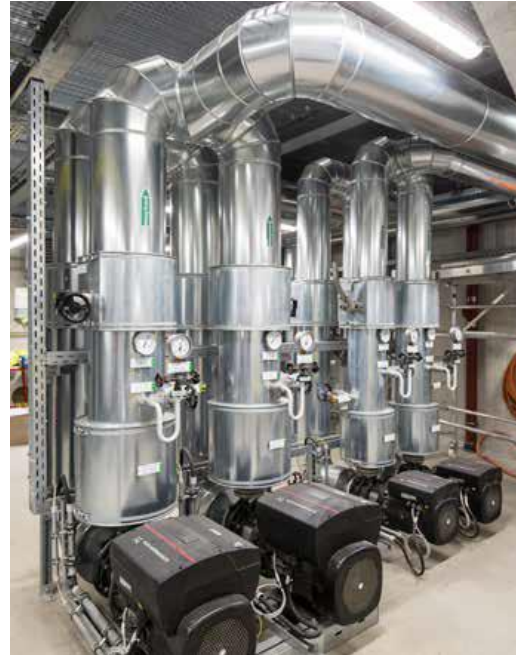
Wärmeeinspeisung ins Netz
