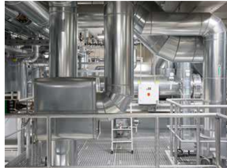
Filteranlagen und Verteilung
